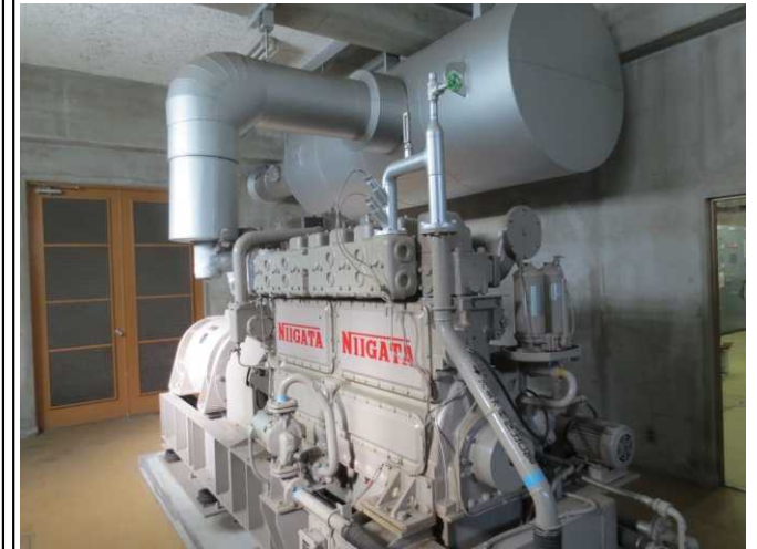
道路設備の耐用年数超過 (非常用発電機)
