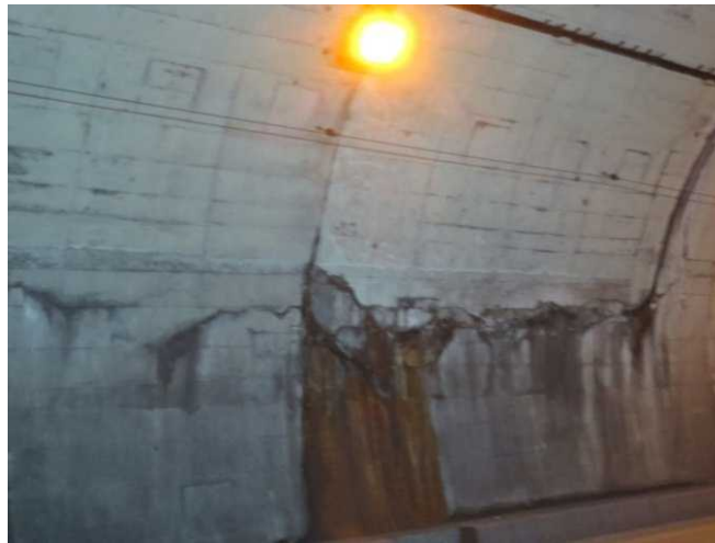
覆工のひび割れ、漏水 (鳴虫山トンネル)
