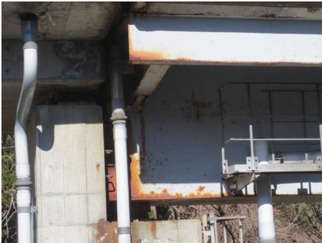
鋼桁端部の発さび (安良沢大谷橋)
