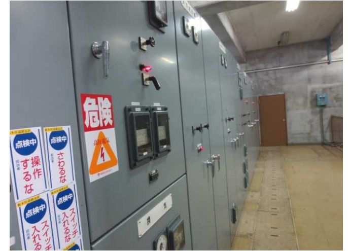
道路設備の耐用年数超過 (受配電設備)
