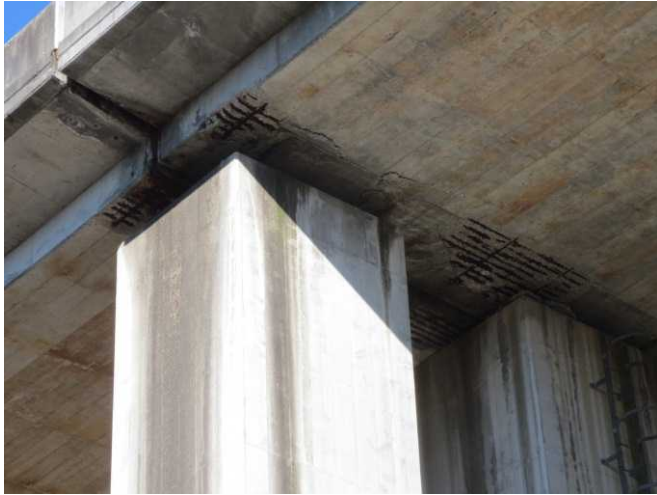
橋梁部材の鉄筋露出 (中野高架橋)
